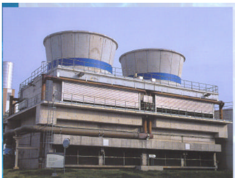
Figura 1: torres de refrigeració
