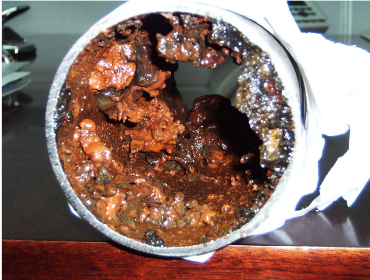
CORROSION - DEPOSITOS CALCAREOS
